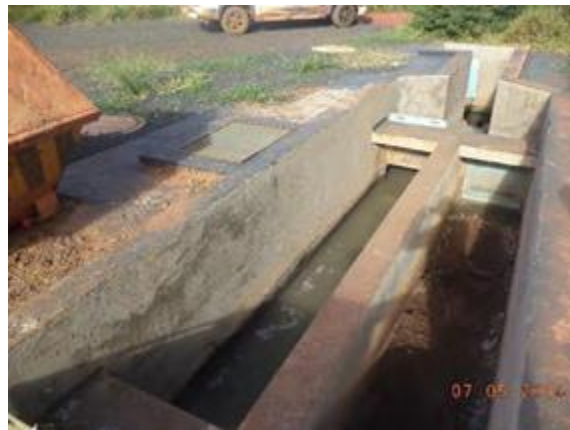
Figura 97. Caixas de areia.
