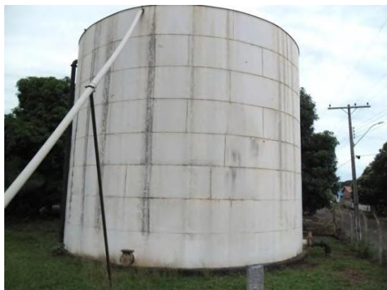
Figura 52. Reservatório da rua 74.
