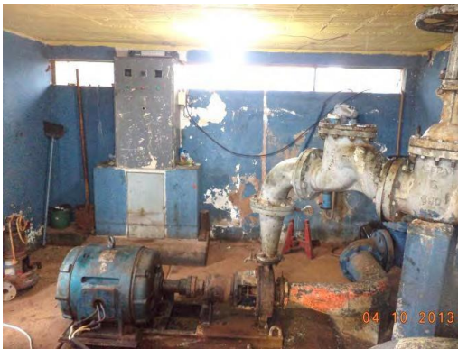
Figura 70. Casa de máquinas.
