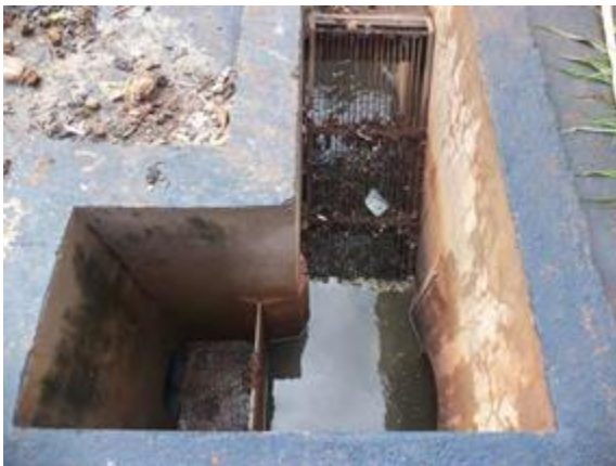
Figura 96. Chegada da ETE e gradeamento.
