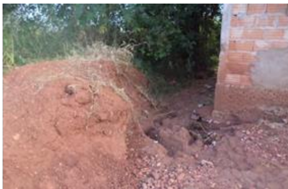
Figura 143. Vista geral da erosão na rua 04.
