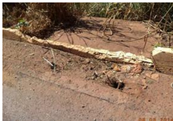
Figura 139. Grelha coletora entupida.
