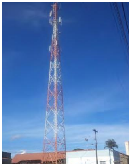
Figura 16. Antena de telefonia celular.
