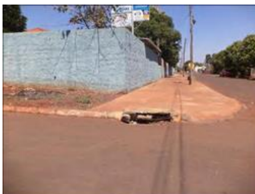
Figura 126. Distrito de Itaguaçu – coletor sem manutenção.
