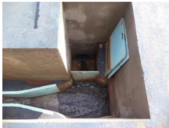
Figura 99. Caixa de passagem.
