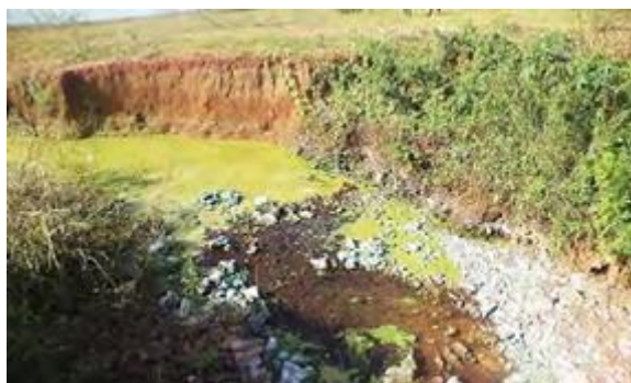
Figura 140. Erosão no deságue da rede de drenagem.
