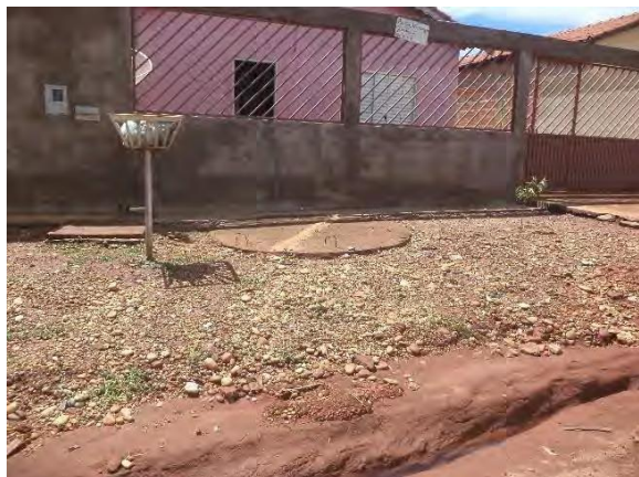
Figura 87. Fossa desativada (de forma inadequada) na sede municipal.
