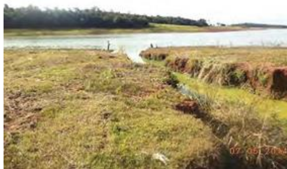
Figura 141. Vista geral da erosão.
