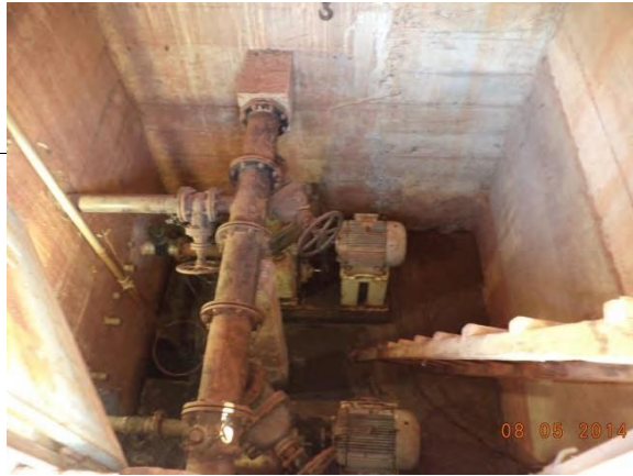
Figura 92. Vista interna da casa de bombas / manobra.
