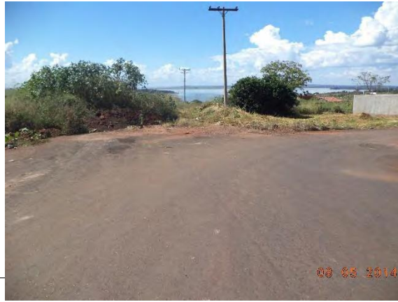
Figura 194. Ausência de guias e sarjetas.
