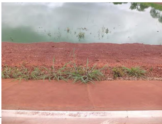
Figura 107. Crescimento de vegetação no talude da lagoa de estabilização.
